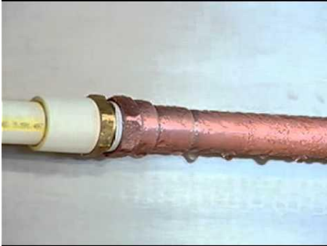
Transición entre hidrobronz y polietileno fusionado
