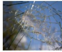
Ruptura del vidrio
