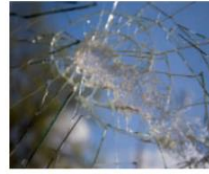
Ruptura del vidrio
