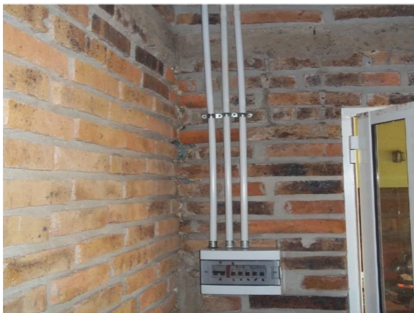
INSTALACIÓN ELÉCTRICA A LA VISTA EN CAÑERÍA DE PVC RÍGIDA IGNIFUGA
